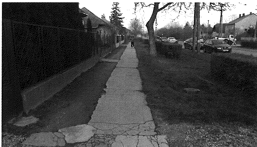
18. számú kép - Járdák állapotfelmérése
